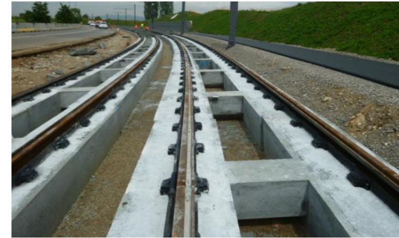
Figure 11 : longrines sans revêtement
