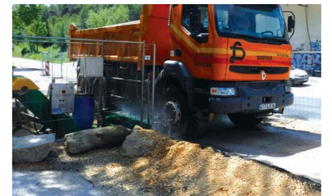
Exemple de pédiluve mobile en entrée de chantier (source : ville de Montpellier)
