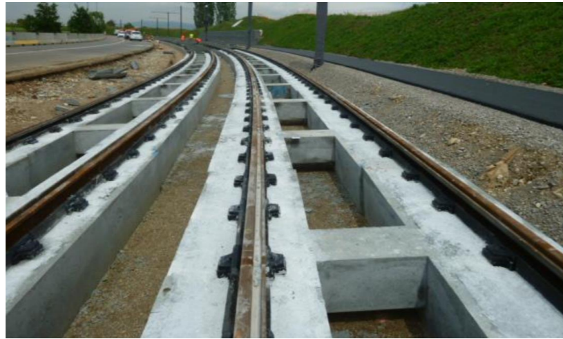
Figure 10 : longrines sans revêtement
