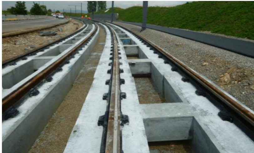
Figure 10 : longrines sans revêtement
