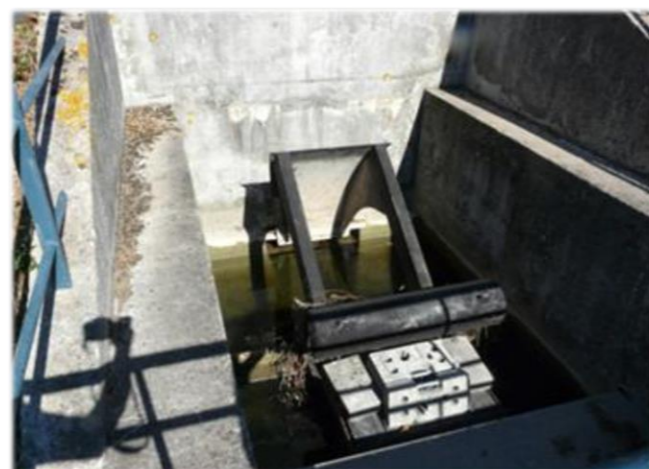
Figure 147 : vanne automatique à flotteur sur le lac de Saint-Avertin
